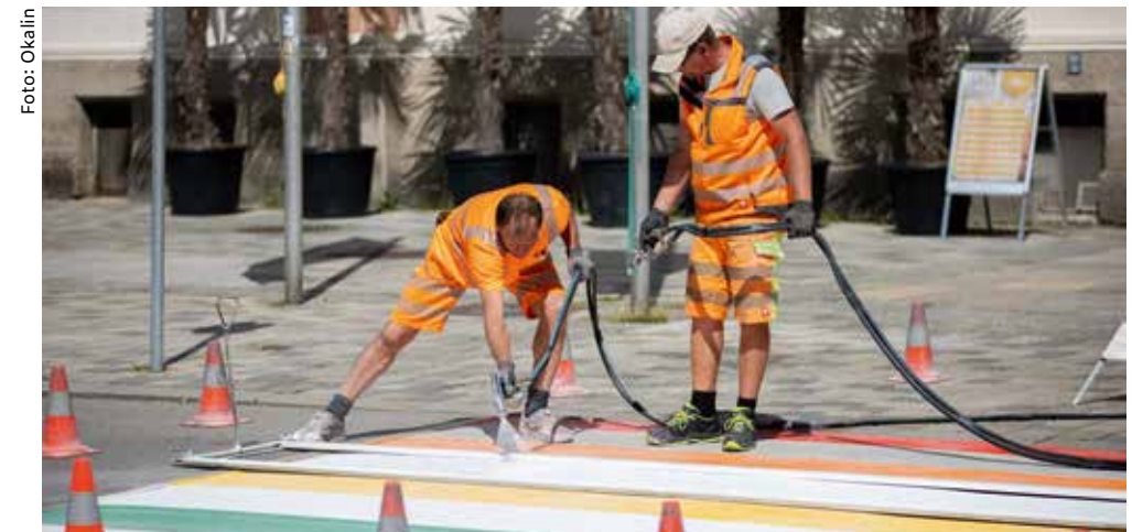
Fahrbahnmarkierungen müssen schnell trocknen, damit die Straße rasch wieder befahren werden kann.
