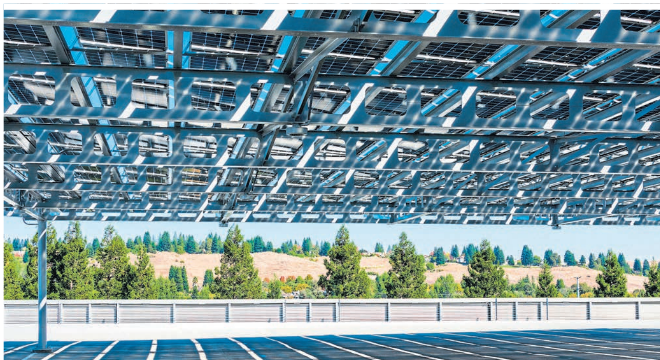
Eine Spezialbeschichtung für Photovoltaik-Rückseitenfolien ist auf die Problematik der Mikrorissbildung zugeschnitten
